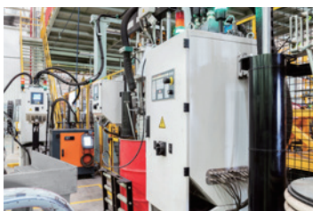
●設備の稼働状況
