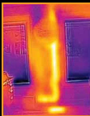
壁内の温水パイプ
