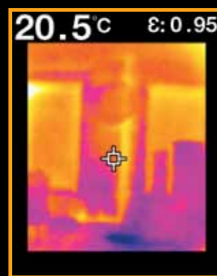
壁内の過熱した配管
