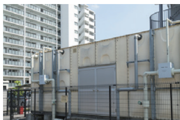
●タンク内の残量監視
