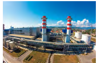
発電所・変電所
