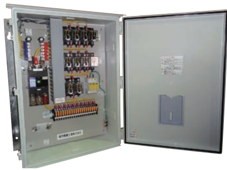
写真ご提供：関西電機工業株式会社 様
